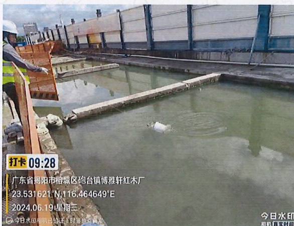
施工 2 标 GX11 生产废水
