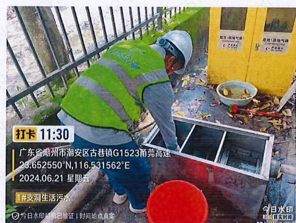
施工 1 标 1#支洞厨房生活污水
