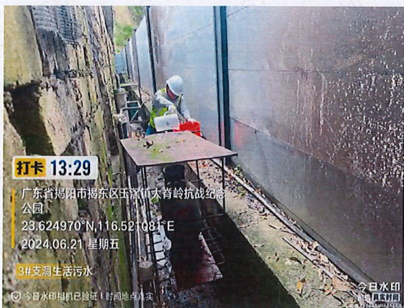
施工 1 标 3#支洞厨房生活污水
