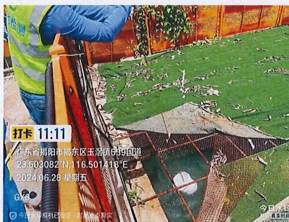
施工 2 标 GX6 生产废水
