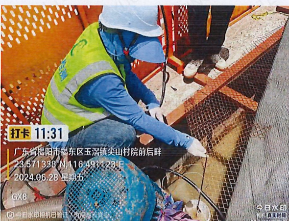
施工 2 标 GX8 生产废水
