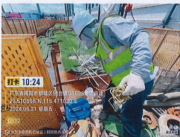
施工 2 标 GX12 生产废水
