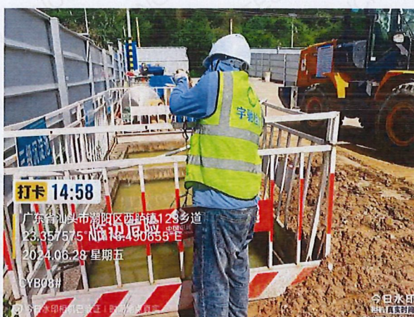
施工 5 标 CYB08#生产废水
